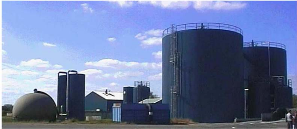
Poz. 4 Společné vyhnívací zařízení pro potraviny, hnůj a ostatní odpady v Dánsku – zásobník bioplynu vlevo; dvě vyhnívací nádrže vpravo spolu s dvěma 70 0 C sanitačními věžemi v jejich stínu.
